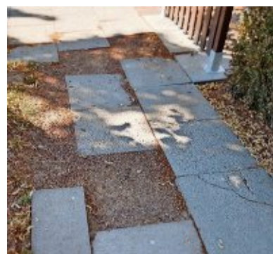
Vor dem Haus von Stephan Böning hat der Bauhof schon etliche Platten entfernt.
